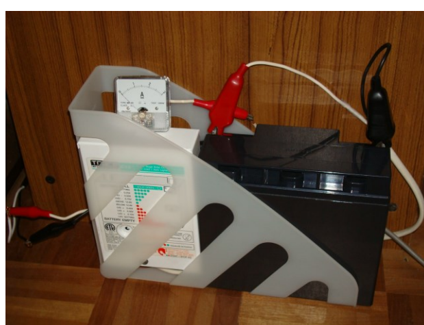
隣室に置かれた電源装置。太陽光発電素子から送られる電流を蓄電池に蓄え、DC/DC変換でアンプに送る
